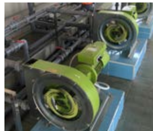
ALP30N lime dosing
